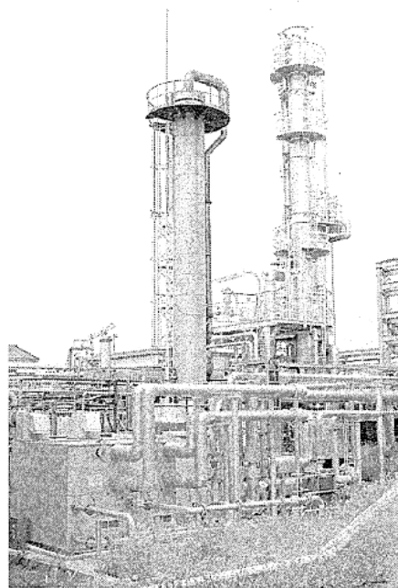
写真1 HP型メタノール蒸留塔（右奥が新設）
